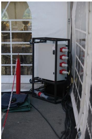
© ATS – Distribution électrique
